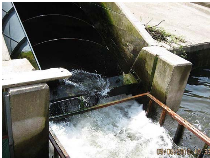
Abbildung 5: Auslaufbereich einer Wasserkraftschnecke an der Werra – Positiv ist die Gestaltung der Betonkonstruktion, negativ ist die turbulente Abströmung (Quelle: [7])
